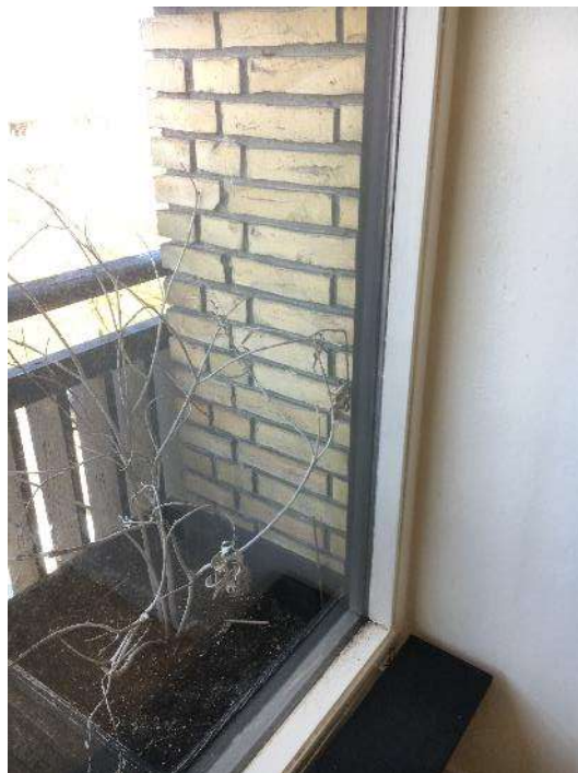
Foto 2, Duevej 4, 3.th, mod gade
