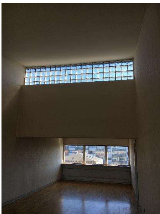
Foto 5, Duevej 28, 6.sal, tagvindue
